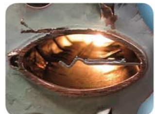
Scambiatore decapato con FERRONEX al 1,5% in 3 ore
